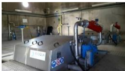
Atelier du traitement tertiaire
